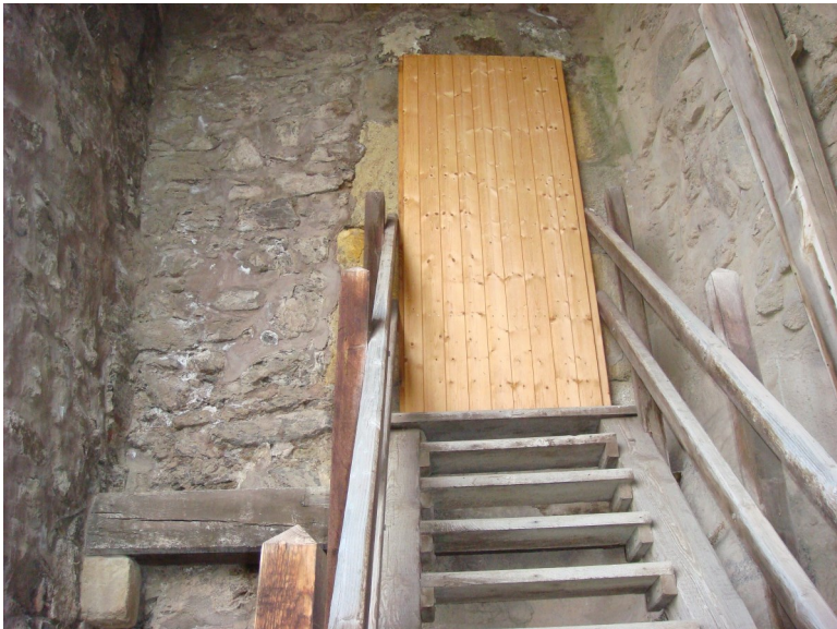
Die verschlossene Türöffnung
